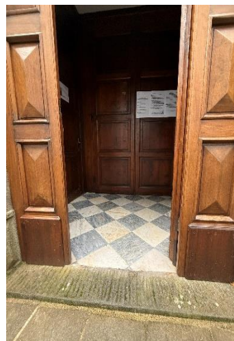
11 portale di ingresso esterno con gradino di 3 cm
